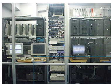
WEBサーバールーム
